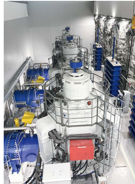
托尔加水电站。 这一新建的径流式水电站配有三台单机容量为15MW的同型号紧凑型混流式水轮机。
