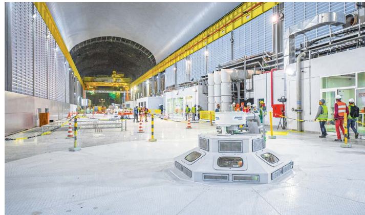
水电站主厂房长达270余米,装有6台单机容量为335MW的机组。
