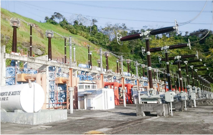
马尔帕索水电站的主变压器
