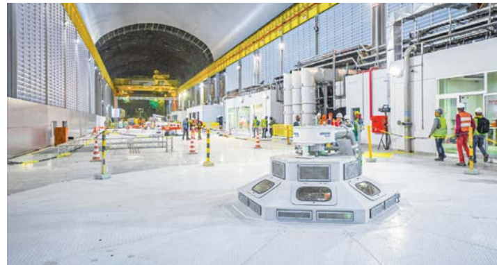
La casa de máquinas principal tiene más de 270 m de largo y cuenta con seis unidades, cada una con una potencia nominal de 335 MW.
