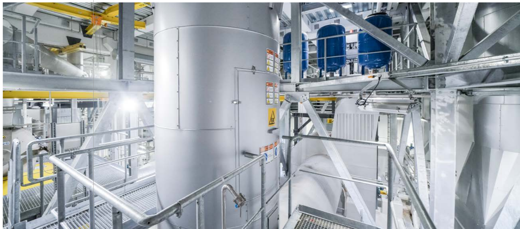
尽管空间有限，设备很容易维护和保养。
